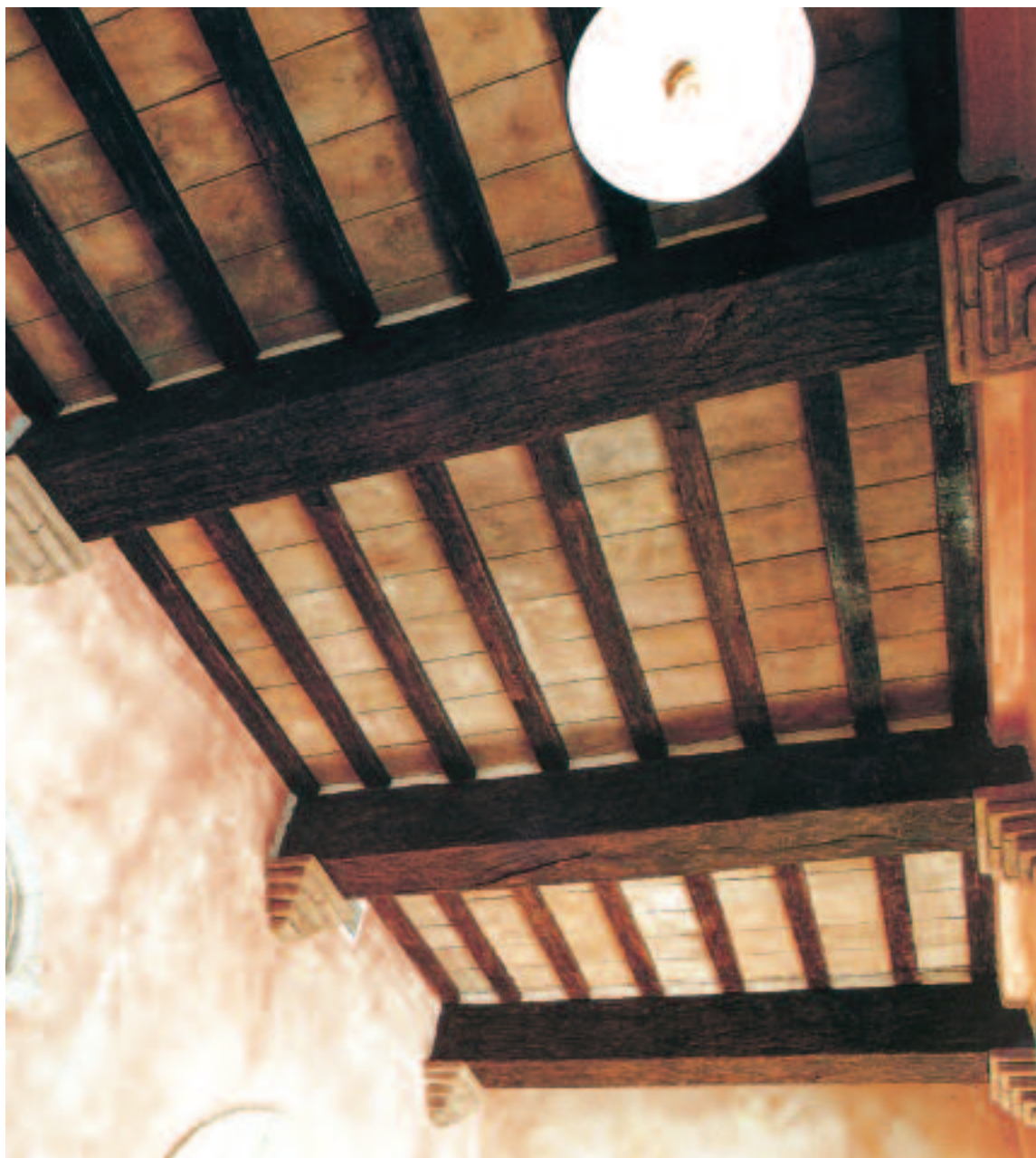
Controsoffitto piano realizzato con fasce 30x20 cm, travicelli da 125 cm fasce pannelle e mensole.
